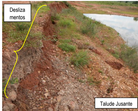
Figura 23 - Deslizamento no talude jusante
