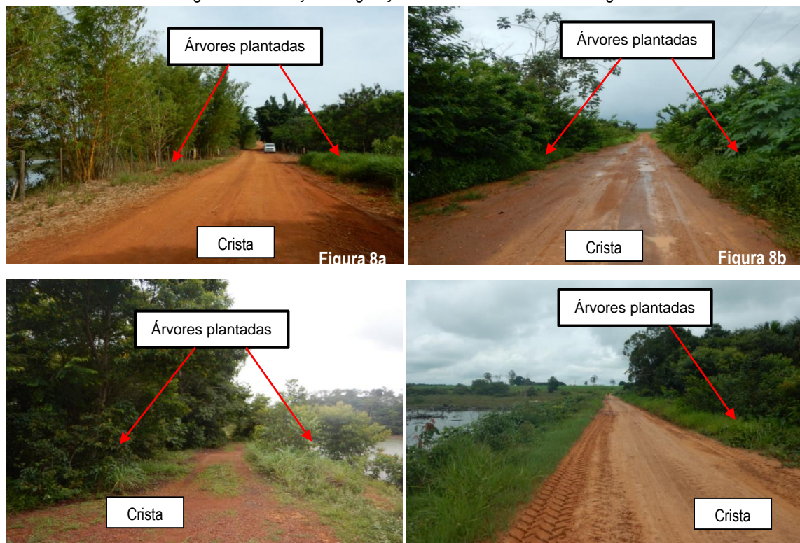
Figura 8 - Presença de vegetação nos taludes e crista da barragem
