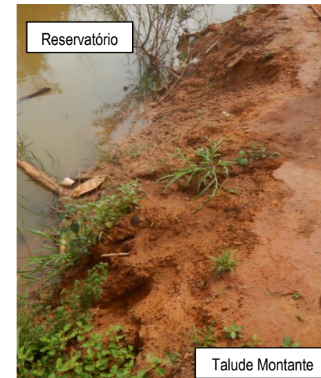
Figura 25 - Deslizamento no talude montante
