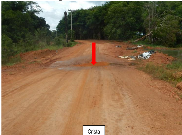
Figura 16 - Afundamento na crista
