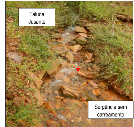
Figura 26 - Surgência localizada no Talude Jusante
