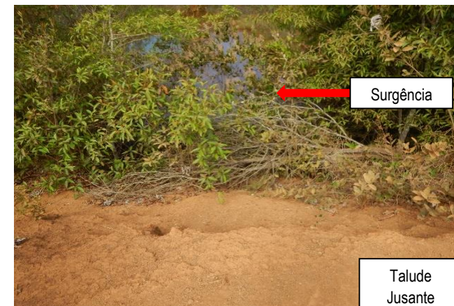
Figura 27 - Surgência na área imediatamente a jusante sem deposição de material carreado
