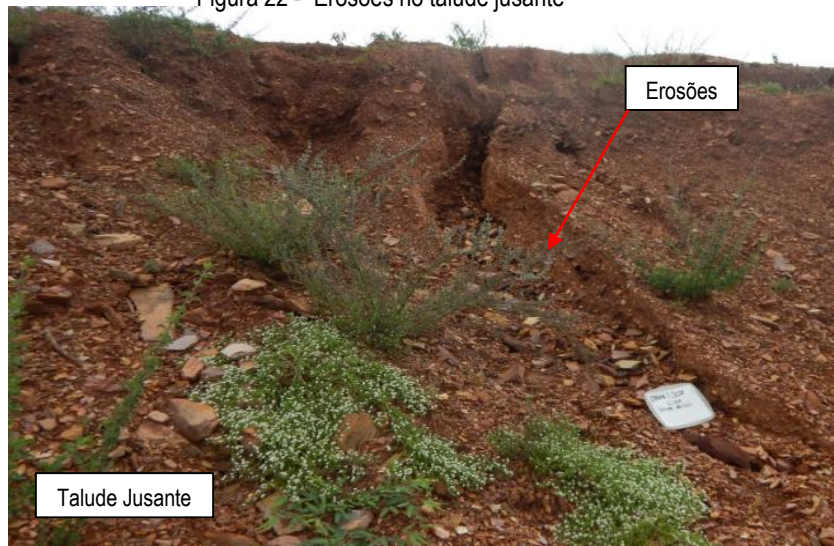
Figura 22 - Erosões no talude jusante
